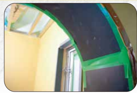
使用養生材：①ブラダン 黒 ②カットエース コメント：円形等、特殊なドア枠に対してブラダンを適当な大きさにカットし、カットエースで固定しています。
